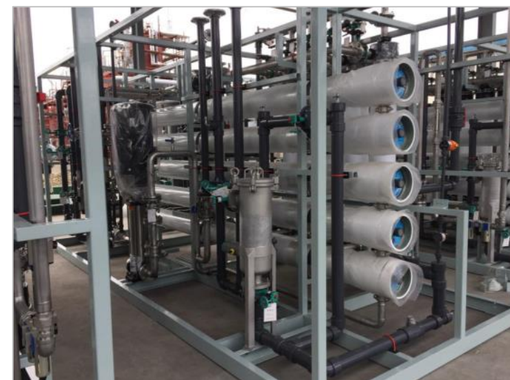
冷却水ブロー水回収システム
